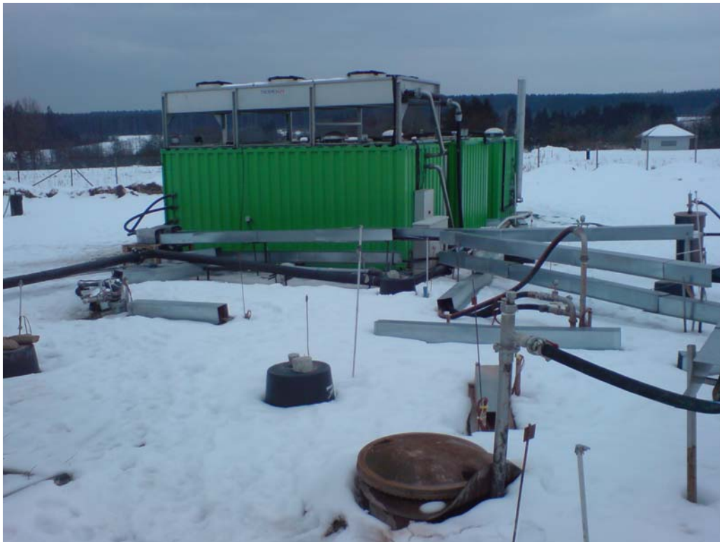
Abb. 1: Sanierungsanlage MOSAM und Ausstattung Pilotfeld (Photo VEGAS 2009)
