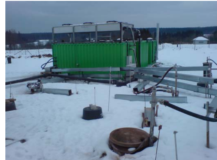
Abb. 1: Sanierungsanlage MOSAM und Ausstattung Pilotfeld (Photo VEGAS 2009)
